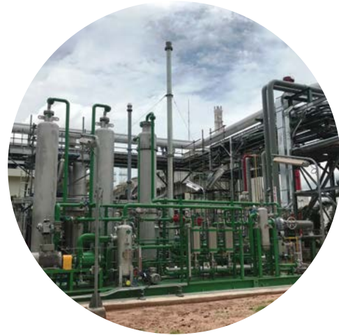
การติดตั้งระบบควบคุมไอระเหย (Vapor Recovery Unit : VRU) หน่วยที่ 2
